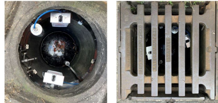
Abbildung 5: Sensorinstallation in den Straßenablaufschächten ohne Schachdeckel (links) und mit Schachdeckel (rechts)
